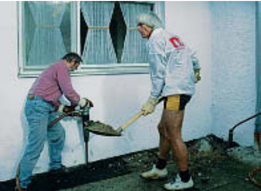
Das war nicht vorgesehen: Das Wasserrohr und der Abfluss müssen freigelegt werden. Bis auf 1,5 m Tiefe wird ausgehoben.
