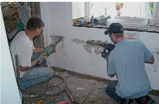
Auch die Küche wird verwüstet. Das warme Wasser kommt künftig aus der Therme im Bad.
